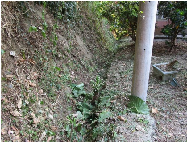
清理前水溝淤塞情形
